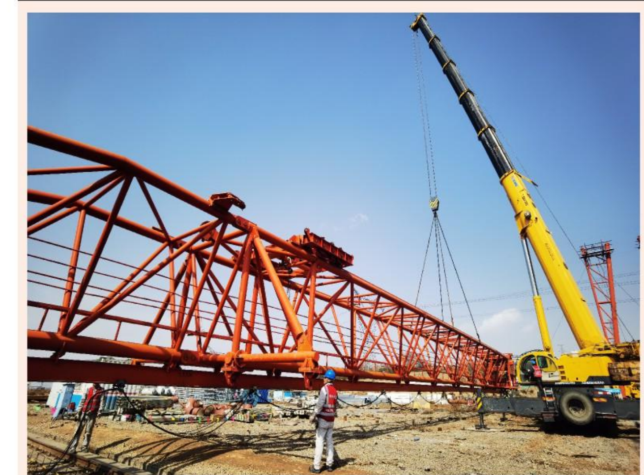
3月12日,内蒙古酸刺沟电厂二期工程场外组合场,40吨龙门吊顺利完成拆除工作。(张洁摄)
